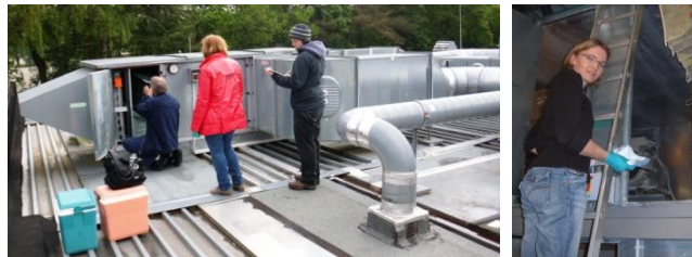
Bild Lafu: Mitarbeiter bei der wiederkehrenden Hygieneinspektion von RLT-Anlagen in Industriebetrieben
